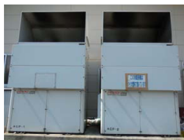
施設空調設備ヒートポンプ
